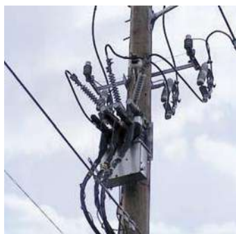
Poste de electricidad
